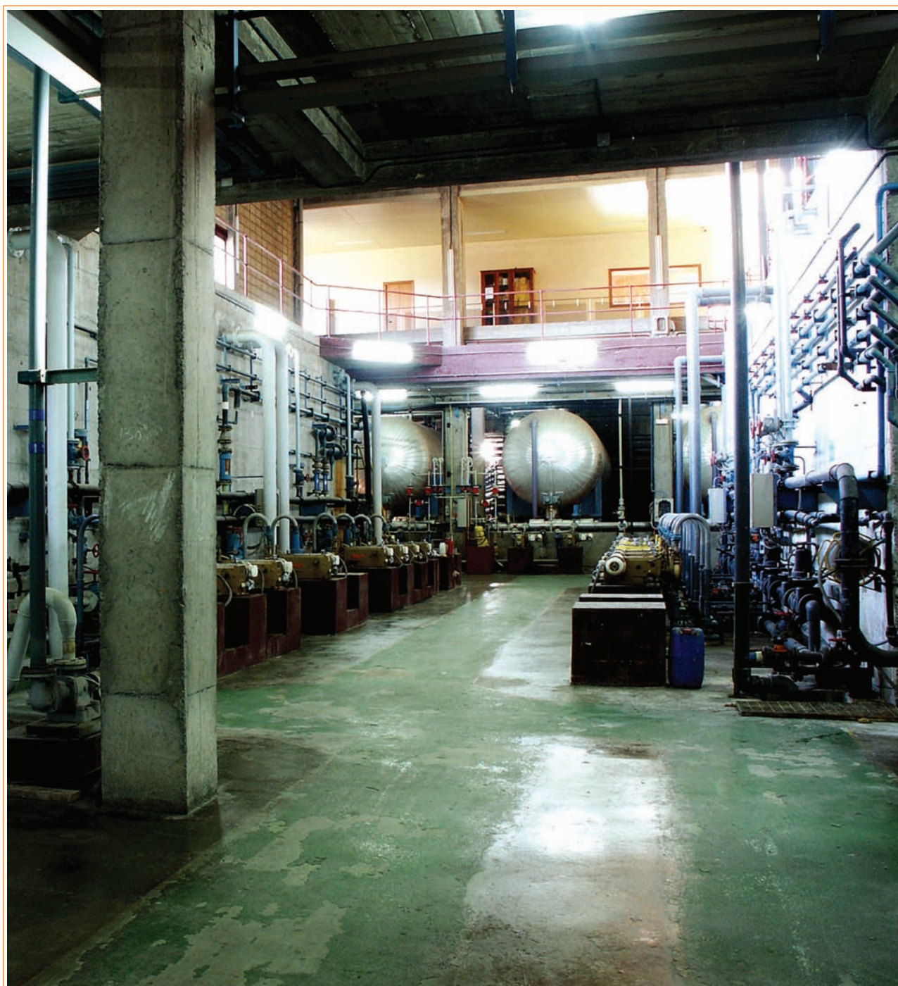
Interior de la E.T.A.P. de Venta Alta
