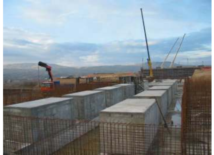
Bancadas en ósmosis inversa
