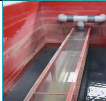
Filtro de arena
