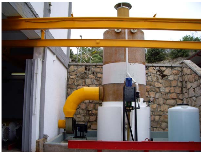
TORRE DE ABSORCION
