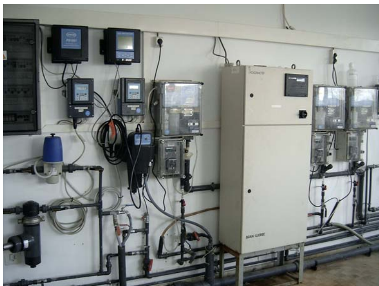
ANALIZADORES EN CONTINUO
