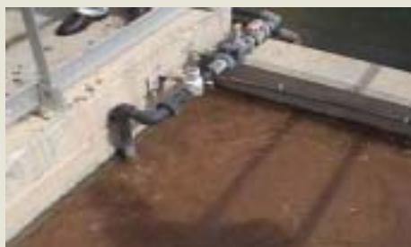
Figura 1. Floculación de lodos purgados de sedimentadores. Segunda etapa de espesamiento.
