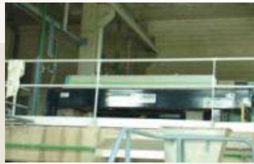
Figura 4. Detalle de centrifugadora y de dosificador de polímero para espesamiento y deshidratación.
