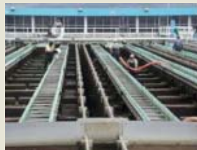
Figura 10. Lavado hidráulico (mangueras y botes) del sedimentador.
