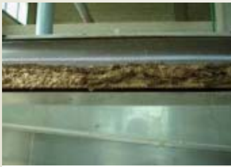
Figura 3. Tamizado de lodos espesados antes de su envío a deshidratación.
