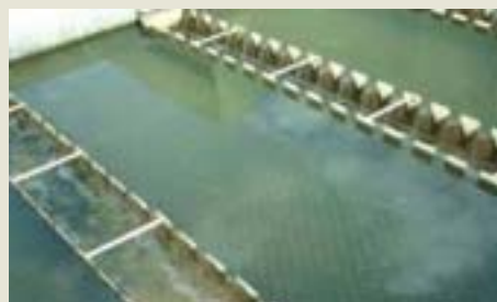
Figura 2. Clarificación de lodos purgados de sedimentadores. Tercera etapa de espesamiento.
