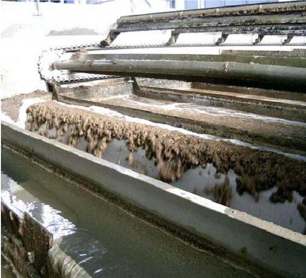
Separación lodo y agua en el flotador
