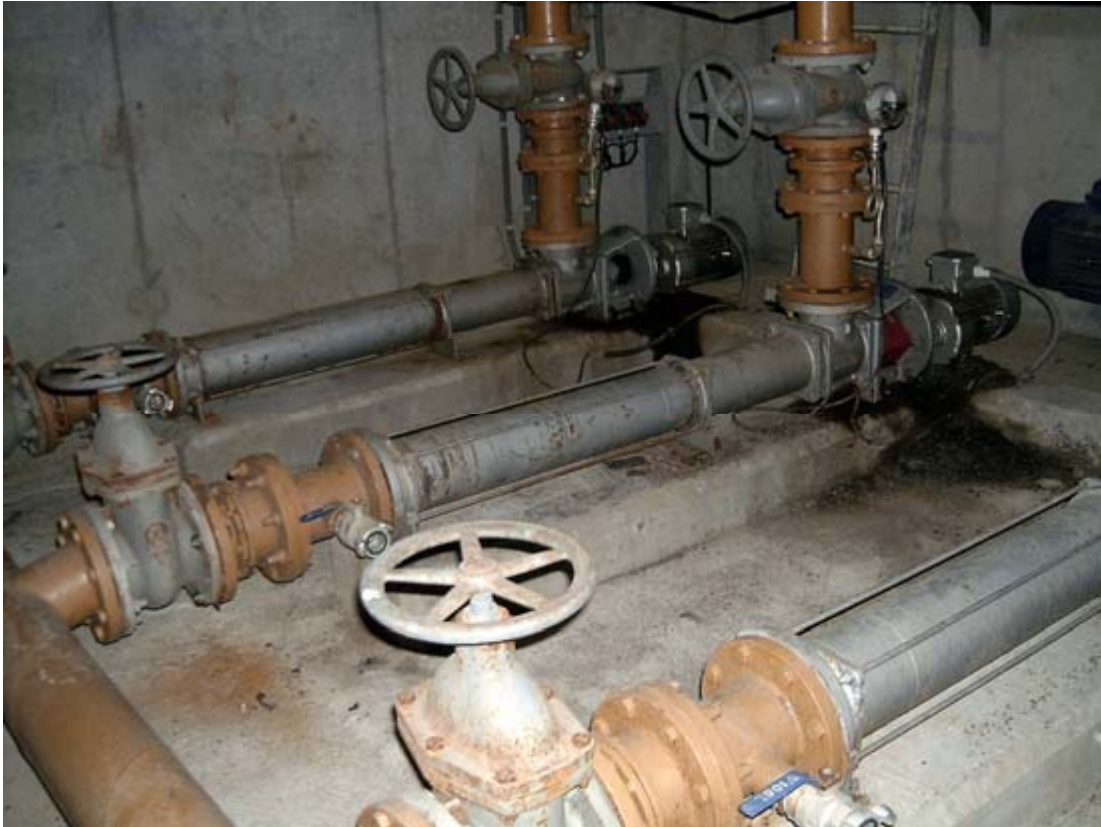
Bombeo de lodos
